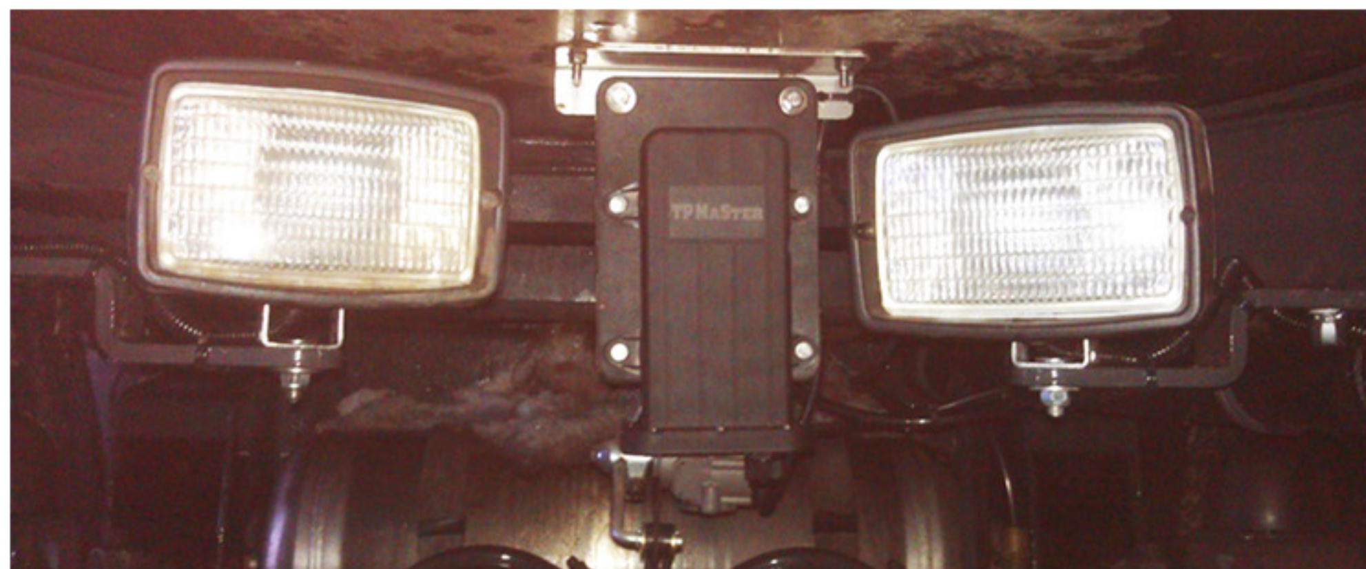
Пример НЕ ПРАВИЛЬНОЙ установки репитера
